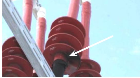
1 de 2 fallas encontradas en la reducción del semiconductor; este defecto no fue detectado con la prueba VLF de PD.
