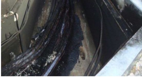
Cable dañado durante la instalación y no detectado con una prueba VLF de PD.
