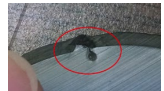
Muestra 4: Abultamiento en la capa semiconductora exterior
